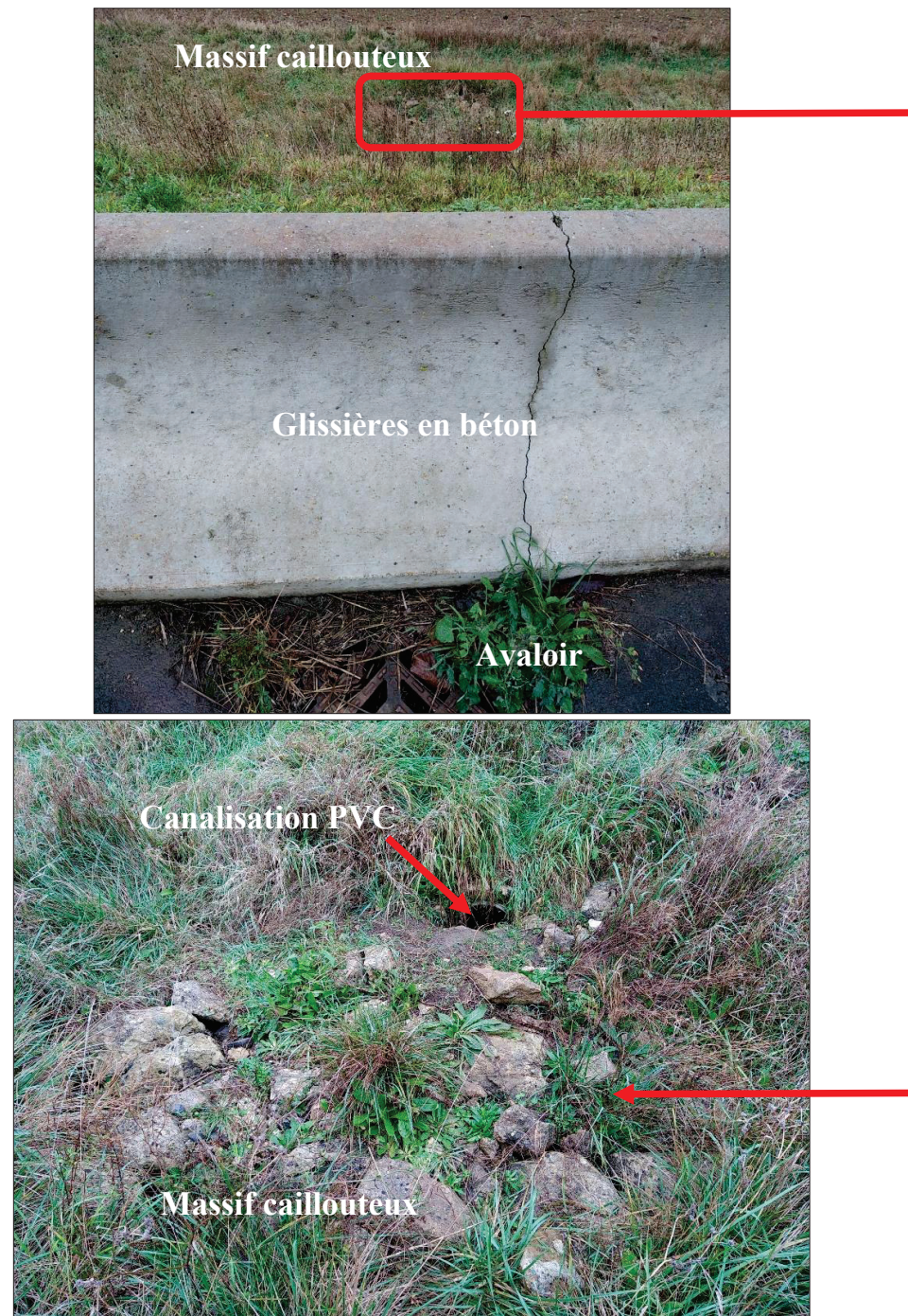
Figure 15 : Illustrations photographiques d'un avaloir, du canalisation PVC et d'un massif caillouteux, observés le 03/11/2021
