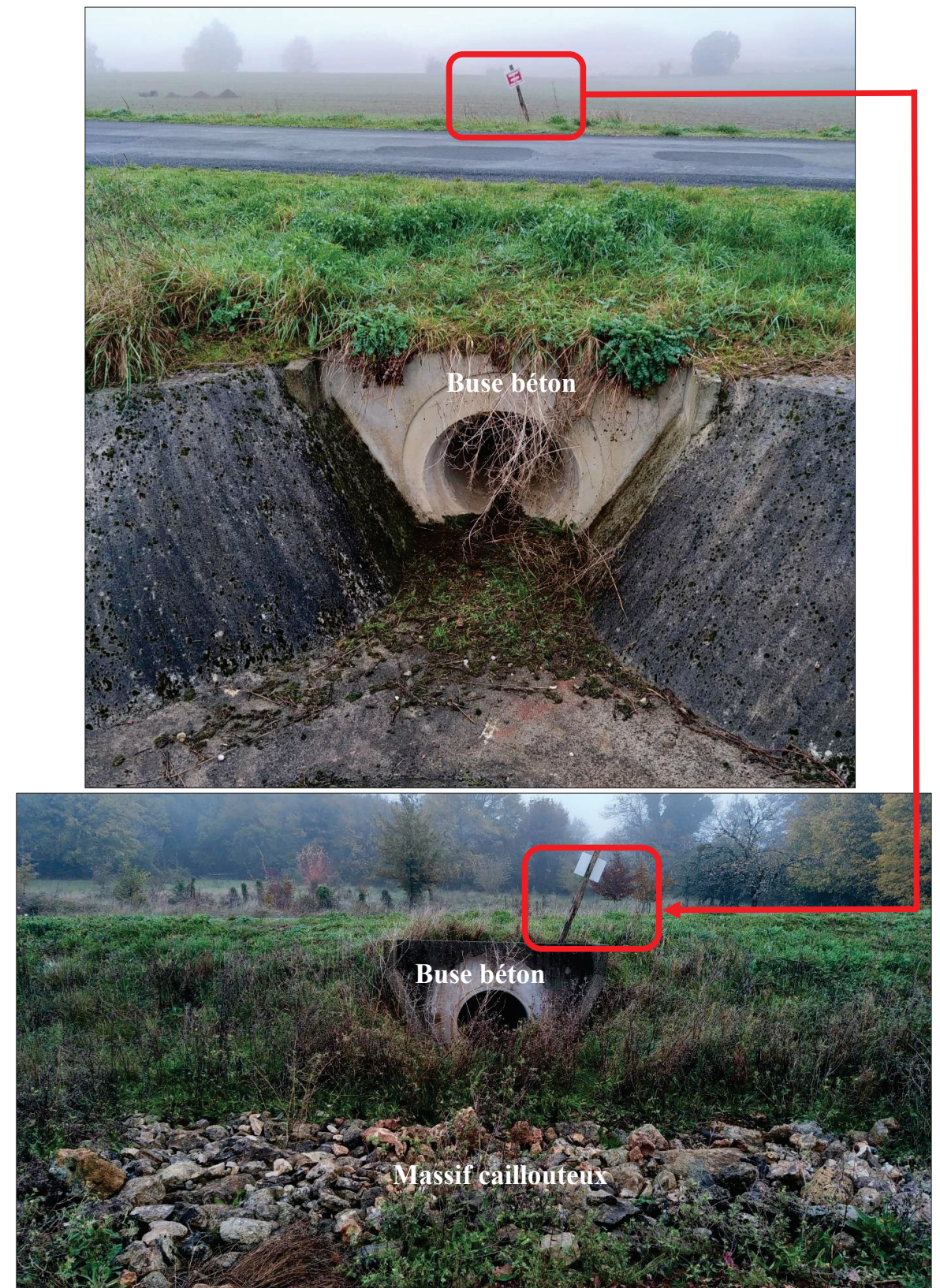
Figure 14 : Illustrations photographiques de la buse béton et du massif caillouteux, observés le 03/11/2021
