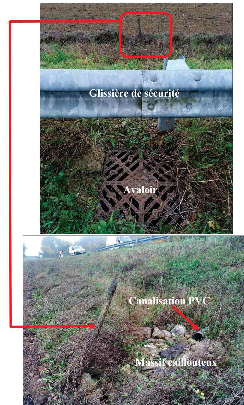
Figure 16 : Illustrations photographiques de l'avaloir, de la canalisation PVC et du massif caillouteux, observés le 03/11/2021
